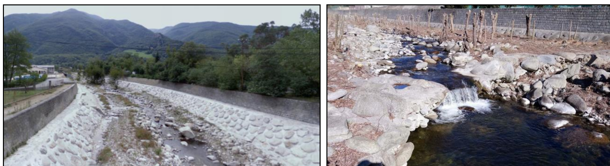
Vue d'ensemble du tronçon concerné (à gauche) et exemple de seuil endommagé (à droite).
