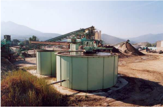
Clarificateur des eaux
