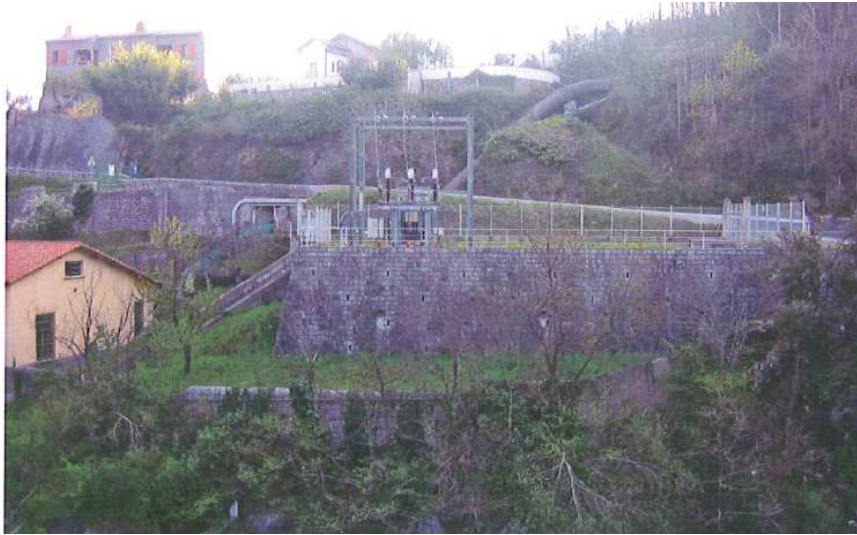
Micro-centrale hydro-électrique au Pas du Loup
