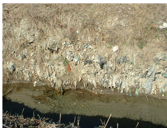
Dépôt sauvage sur le canal à Céret
