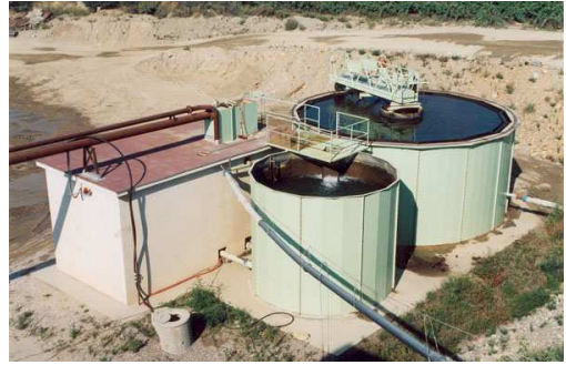
Traitement des boues
