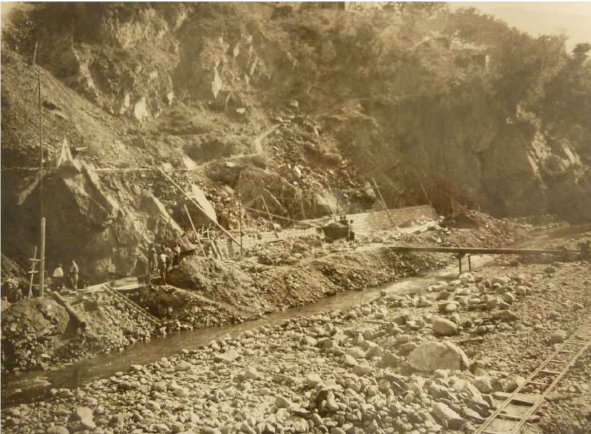
Fig 13 - Vue générale des travaux de reconstruction de la route nationale n°115, entre Céret et Amélie-les-Bains, au lieu-dit les Embaussades (Reynès), 10 septembre 1945. ADPO, 1443W2.
