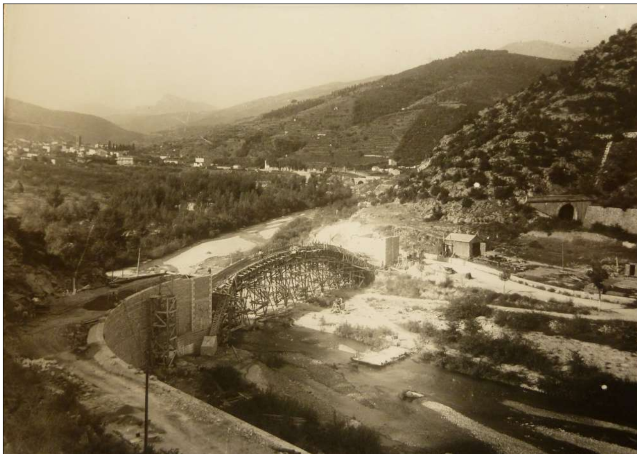
Reconstruction du Pont Neuf d'Arles-sur-Tech sur la RD 115 emporté par l' aiguat d'octobre 1940, s. d. [vers 1947]. ADPO, 111W3.
